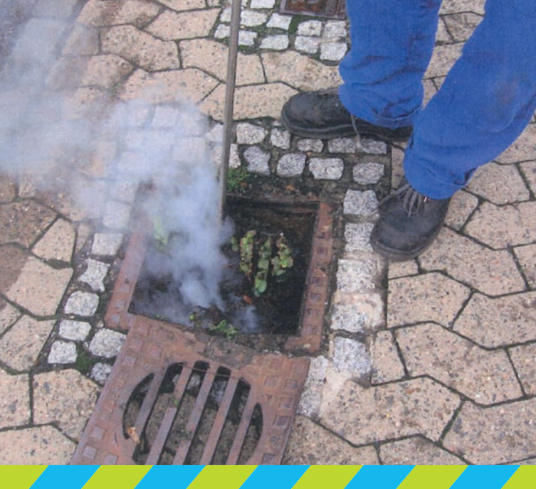
Abbildung 1: Falschanschluss eines Hofeinlaufes an den Schmutzwasserkanal (mit Signalnebel festgestellt).
