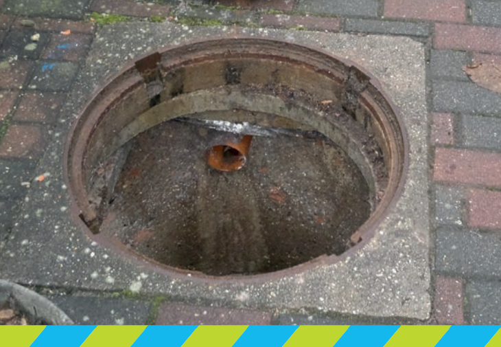
Abbildung 3: Falschanschluss einer Drainrinne an einen Schmutzwasserübergabeschacht
